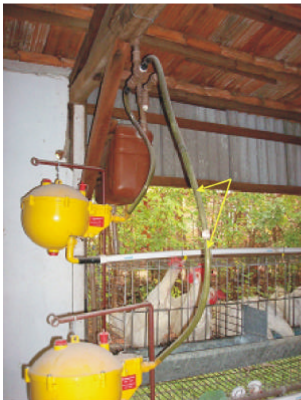
Fig. 2 - Biofilme na tubulação do bebedouro.
